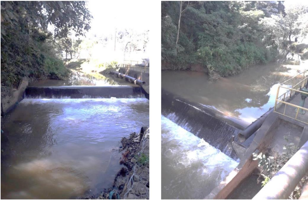
Figura 10 - Barramento junto ao Rio Jundiáí (à esquerda) e captação de água (à direita) da empresa Thyssenkrupp, no município de Campo Limpo Paulista FONTE: PROFILL (2021) .
