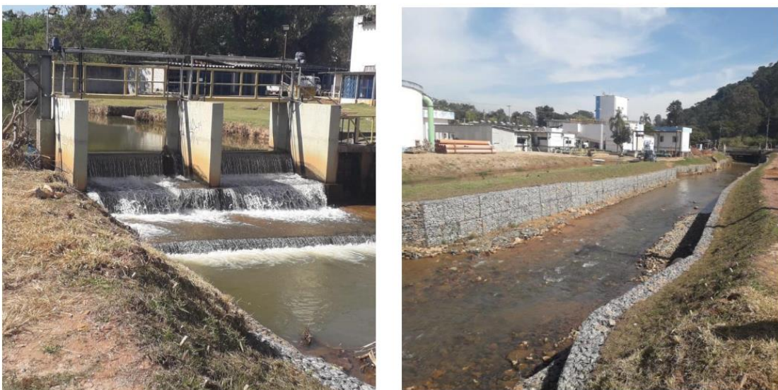
Figura 11 - Barramento no Rio Jundiáí para captação da SABESP (à esquerda) e retificação do Rio Jundiáí no trecho de captação da SABESP (à direita), no município de Campo Limpo Paulista. FONTE: PROFILL (2021) .
