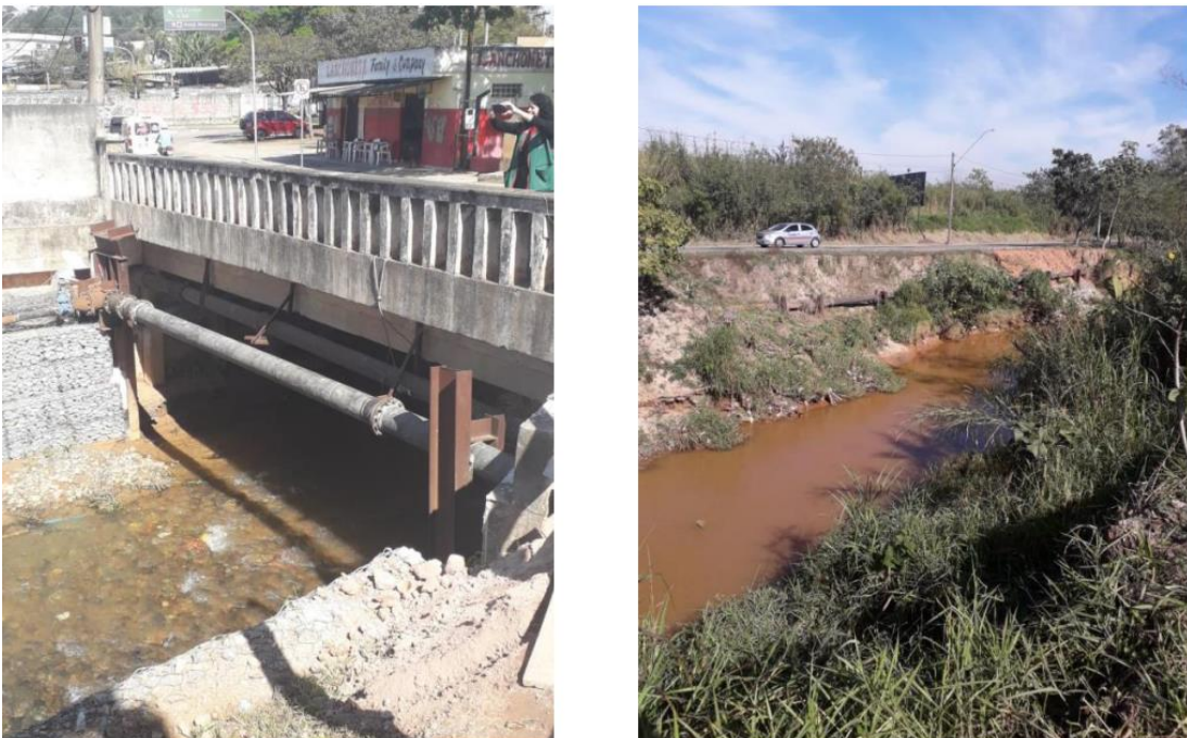
Figura 9 - Ponte Emancipadores sobre o Rio Jundiá, apresentando cruzamento de tubulação (à esquerda) e erosão às margens do Rio Jundiá observada no município de Campo Limpo Paulista (à direita) FONTE: PROFILL (2021).
