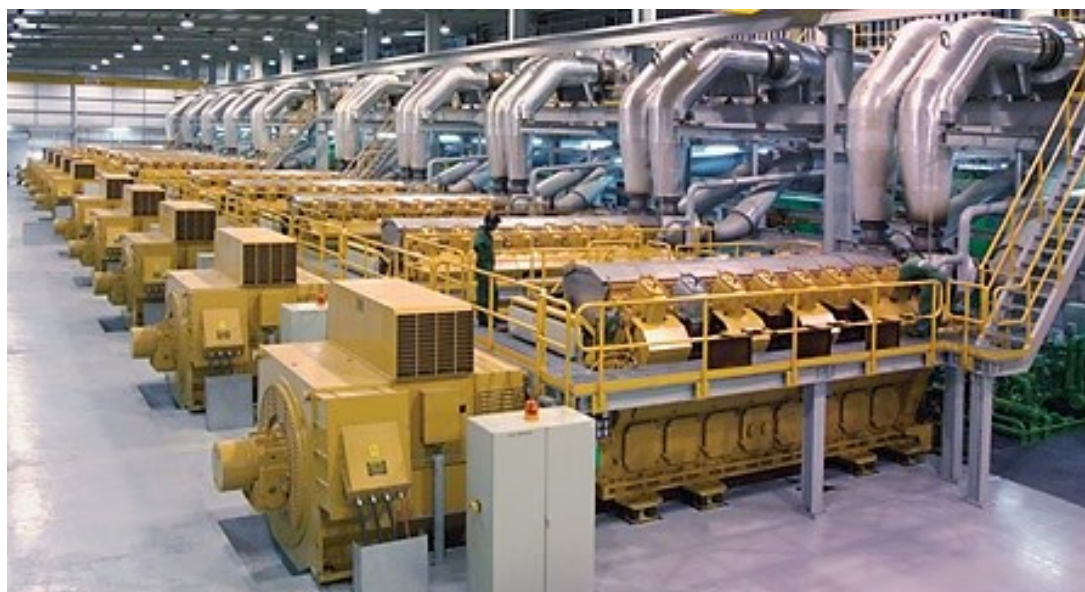
Figura 1 Data Center. Sistema de Geradores à Diesel.
