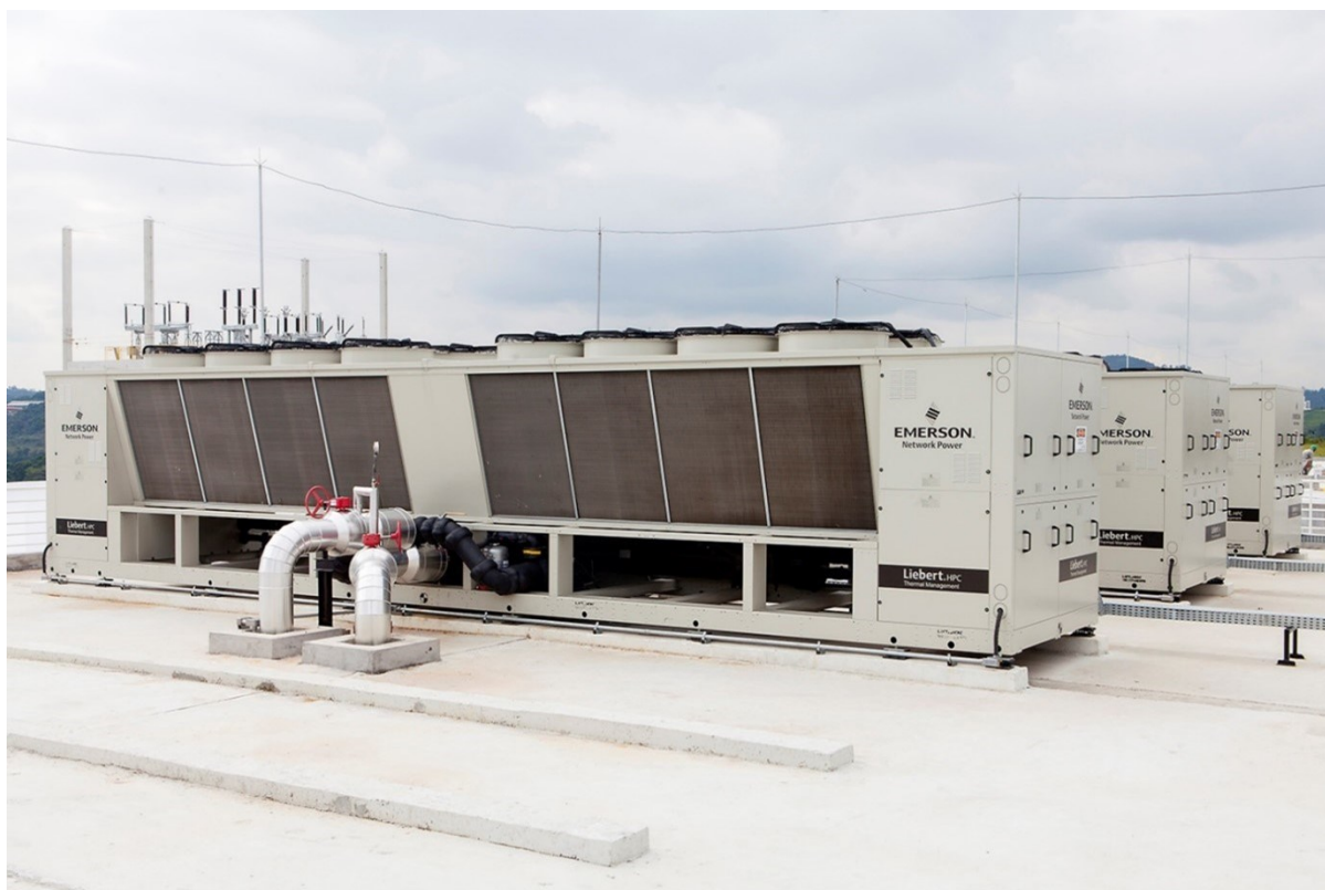
Figura 4 Data Center. Trocadores Externos de Calor.
