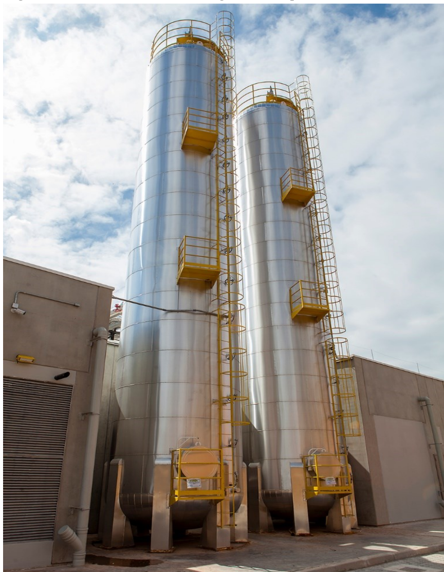
Figura 5 Data Center. Torres de Água Gelada para Resfriamento.
