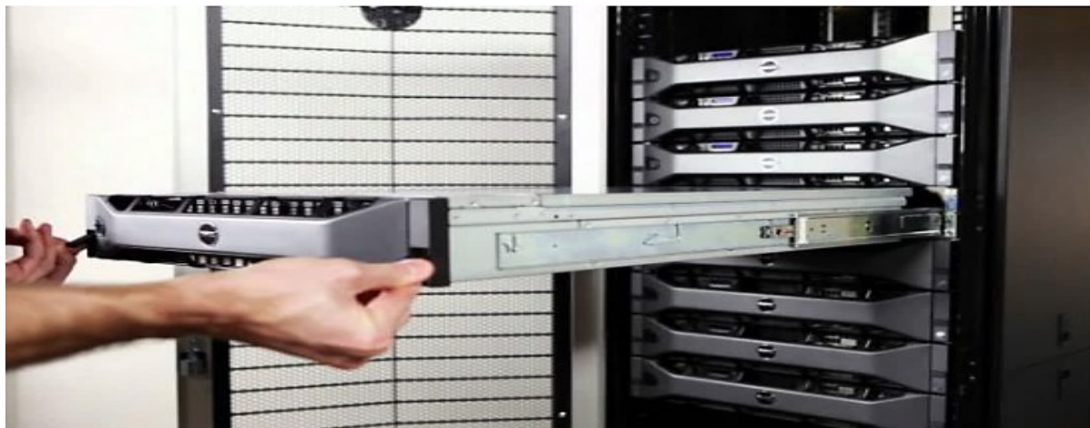
Figura 2 Data Center. Servidor Inserido em Rack.
