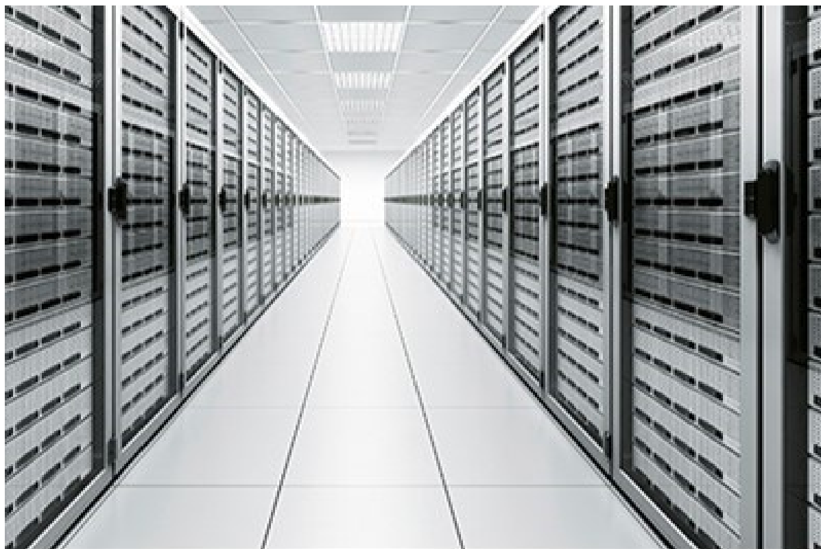
Figura 3 Data Center. Visão de uma Sala de Servidores Instalados em Racks.
