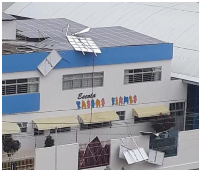
Figura 18. Incidente em Campina Grande – PB ocasionado pela força do vento.
