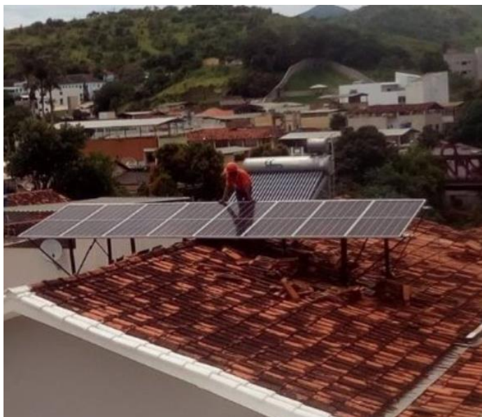
Figura 17. Instalação inadequada de placa solar fotovoltaica. Fonte: Villalva, 2019.
