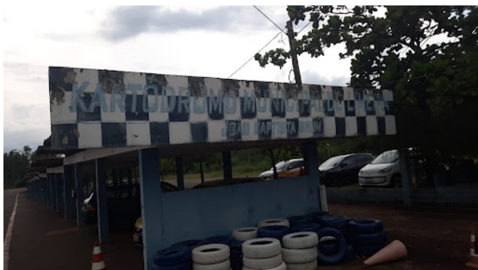
Figura 7 – Fachada do Kartódromo sem reforma das pinturas
