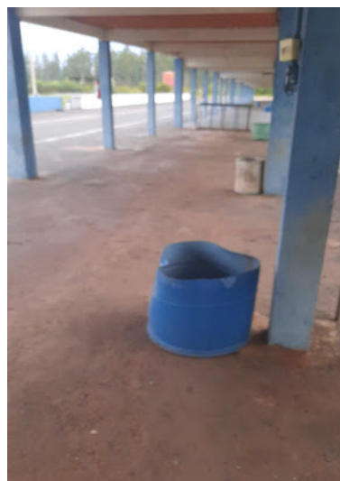
Figura 13 – Lixos deformados e cabeamento e estrutura elétrica do local
