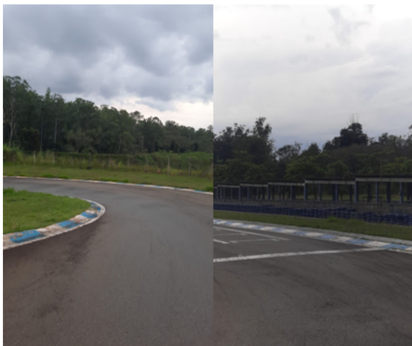
Figura 22 – Escoamento inadequado e falta de contenção de concretos
