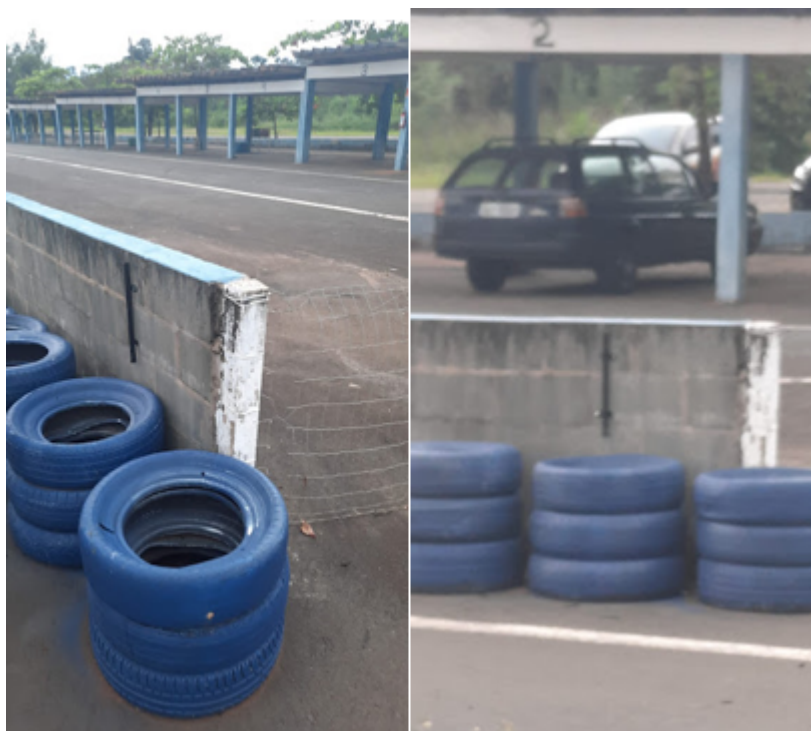
Figura 17 – Quina do muro que pode ser perigosa e suporte para bandeira
