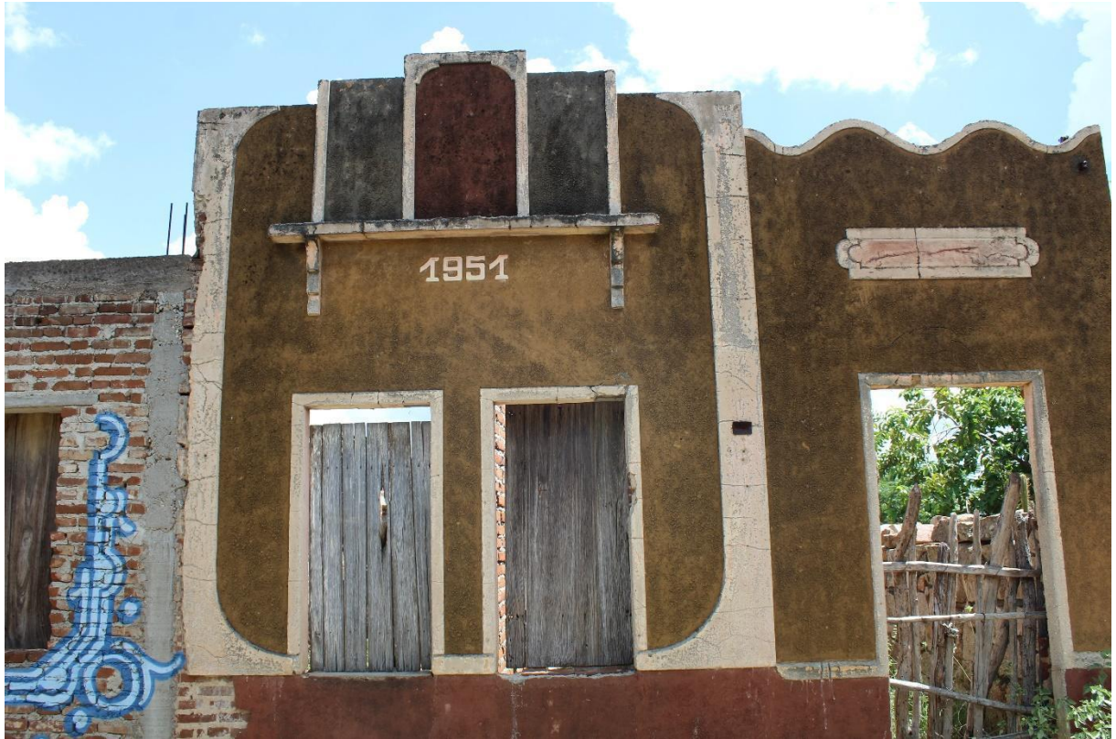
Figura 5 - Ruína de fachada de casa datada de 1951
