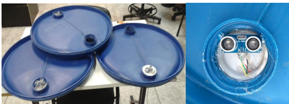
Figura 11: Sensores ultrassônicos instalados nos reservatórios.
