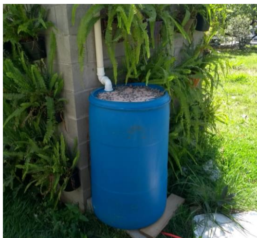
Figura 9: Reservatório de armazenagem de água.
