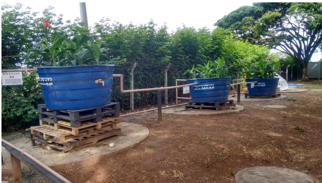
Figura 5 - Wetlands construídos em série no local de estudo. Fonte: Autor, 2018.
