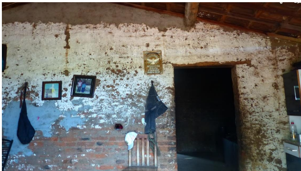
Figura 8. Casa na área rural de Marcelino Vieira, RN sem reboco completo e teto sem forro
