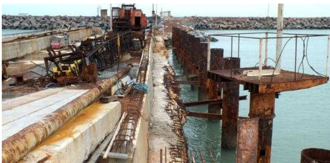
Figura 14 - Estrutura deteriorada no Porto Luís Correia. Fonte: Redação do Jornal Online ClubeSat – PI, 2015
