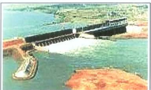
Porto Primavera. A hidrelétrica em construção será a 2ª maior do Estado. Utiliza uma eclusa provisória para navegação.
