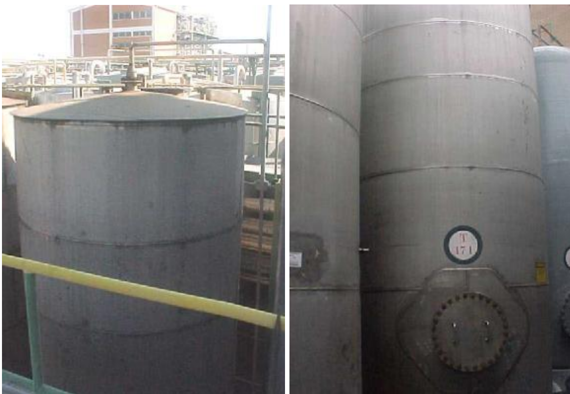
Figura 19: Tanque de 25 m 3 com sistema de recirculação.
