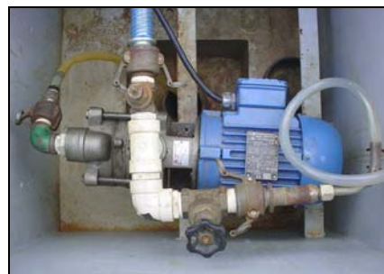
Figura 5.2: Detalhe superior da bomba elétrica instalada no PM-11
