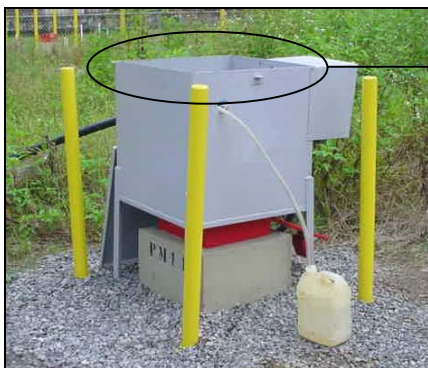
Figura 5.1: Vista geral do poço de monitoramento (PM-11) utilizado para coleta da água subterrânea
