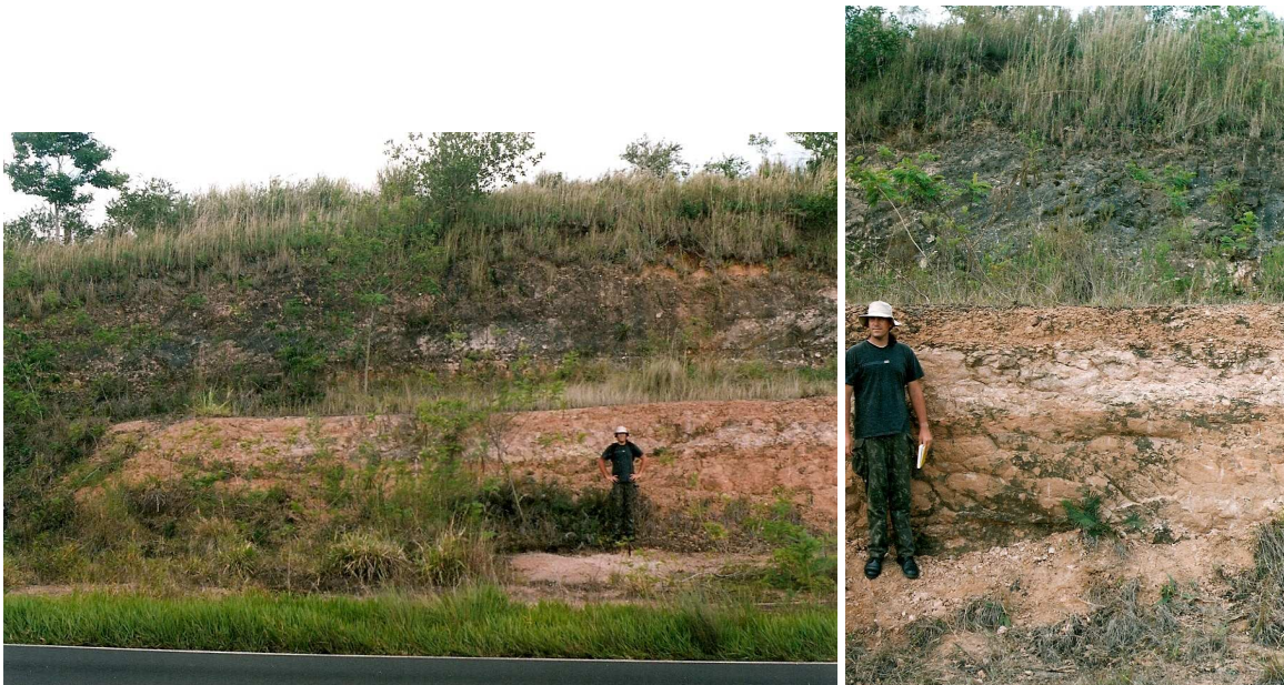
Figura 10.5 – Imagem do 4º perfil mascado por solos com mosqueamento bastante pronunciado e rico em bioturbações (crotovinas e rizoconreções). Parte dos horizontes está no pavimento acima da linha de aplainamento antropico.
