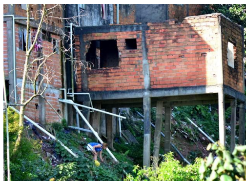
Figura 1.2 - Moradias construídas no talude do morro, lançando água servida no terreno Fonte: autora, 2011
