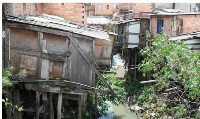
Figura 6.2: Casas em áreas de risco de solapamento de margem de córrego, na Subprefeitura da Vila Prudente, São Paulo – SP
