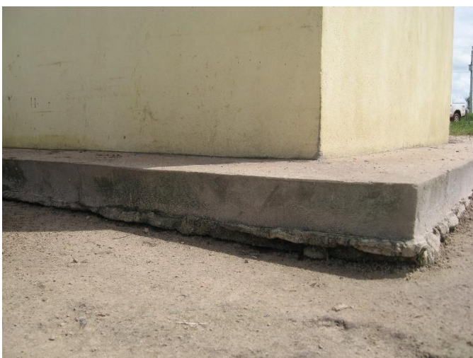
Figura 26: Arraste do solo provocado pelas chuvas Fonte: Ministério Público Federal - TO
