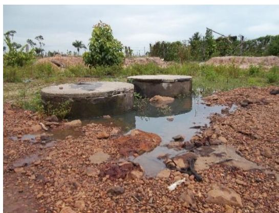
Figura 28: Fossa e sumidouro em terreno alagado Fonte: Ministério Público Federal - TO
