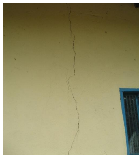
Figura 27: Rachaduras nas paredes Fonte: Ministério Público Federal - TO
