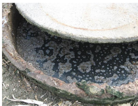
Figura 29: Vista do nível de efluente da fossa Fonte: Ministério Público Federal - TO
