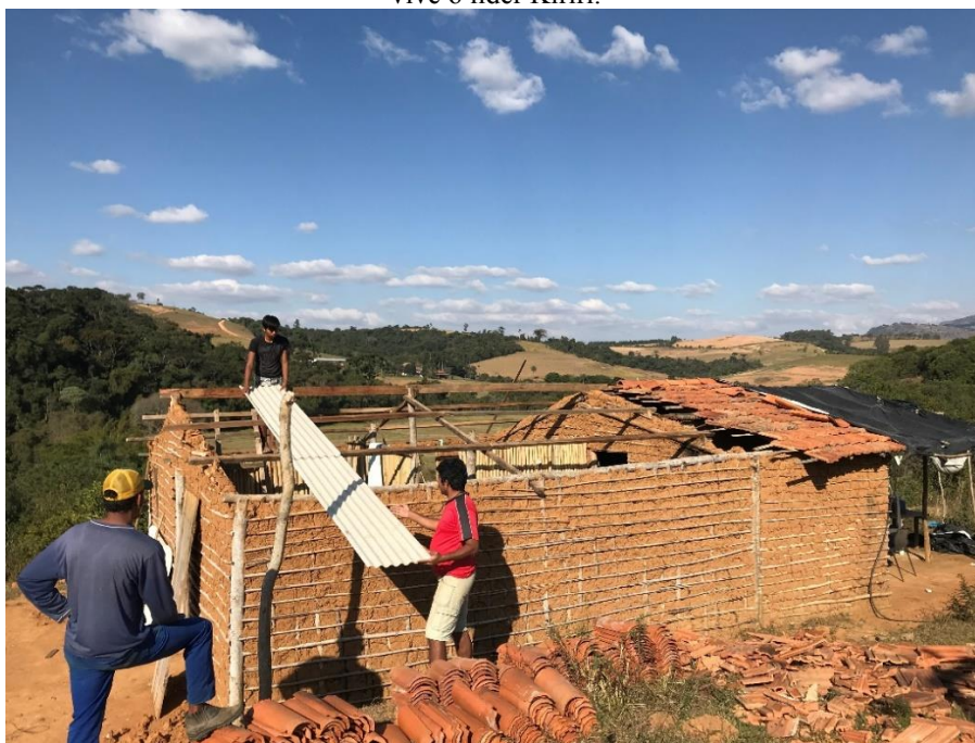
Figura 9: Chefe Kiriri, seu filho e sobrinho cobrindo uma das casas no Rio Verde. Cacique Adenilson segurando a telha na parte externa da casa e seu filho mais novo segurando a mesma telha em cima da estrutura. Ao lado, Cleison, filho de Roseni observa o cacique e seu filho cobrirem a casa onde vive o líder Kiriri.
