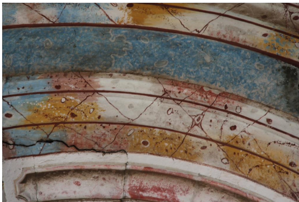
Figura 19 - Detalhe da pintura da cimalha (com rachadura no quadrante inferior esquerdo). Fonte: Acervo da autora, 2014.
