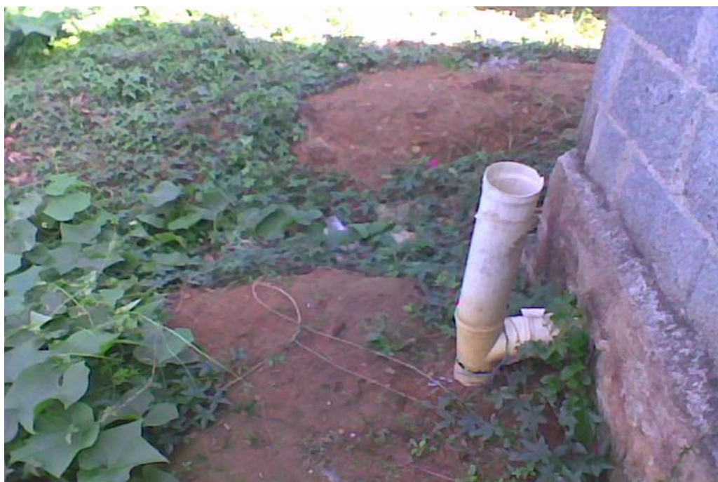
Figura 7 – Fator de risco de deslizamento: sistema precário de esgoto
