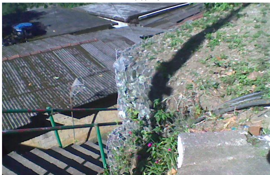
Figura 13 – Exemplo de estratégia de adaptação: muro de arrimo visando proteger casas abaixo
