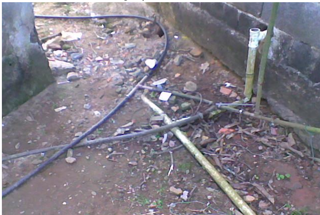
Figura 6 – Fator de risco de deslizamento: sistema precário de serviço de fornecimento de água para a residência
