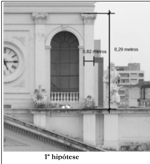
Figura 44: Altura da pilastra da Ordem Coríntia da fachada da Catedral Nossa Senhora da Conceição de Campinas.
