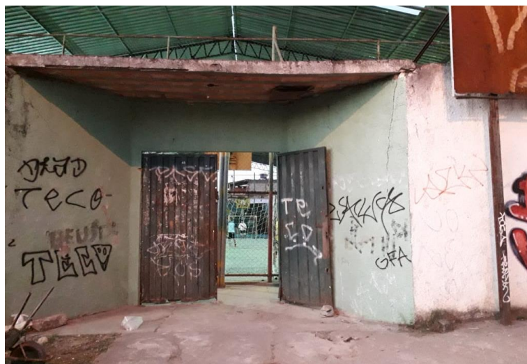
FIGURA 39 – Portão de entrada da quadra do Conjunto em Veneza, Ribeirão das Neves
