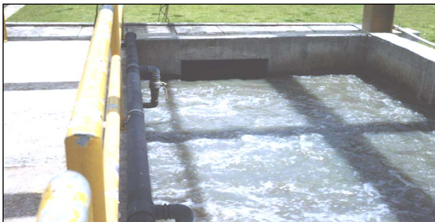
Figura 3. Caixa de areia com o vertedor.
