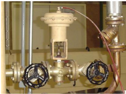
Figura 3.12 - Válvula pneumática da malha de controle de temperatura
