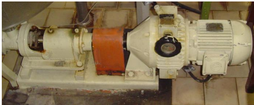
Figura 3.10 - Bomba de deslocamento para fluido de processo
