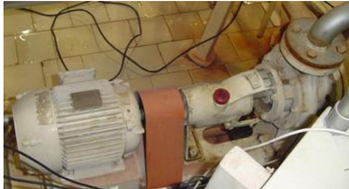
Figura 3.11 - Bomba centrífuga para circulação de água quente
