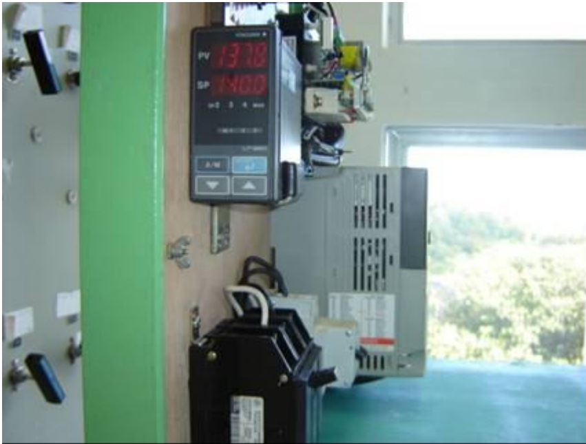
Figura 65. Vista frontal do controlador de temperatura e lateral do painel de comando.
