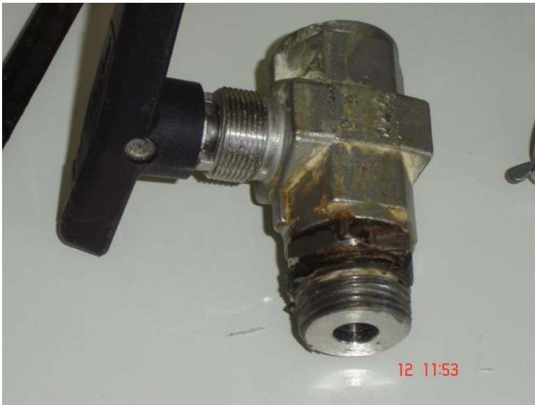
Figura 82. Detalhe da incrustação na válvula de fundo do reator.
