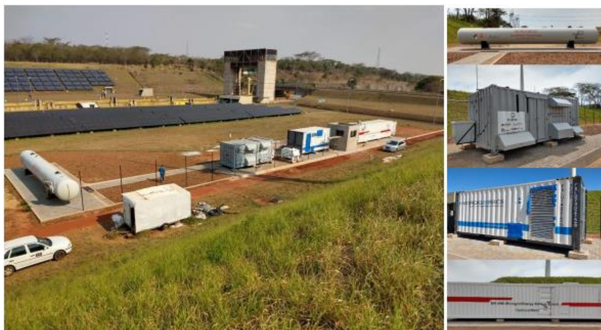
Figura 2.4: Equipamentos instalados na UHE Porto Primavera Fonte: Riedel (2019)
