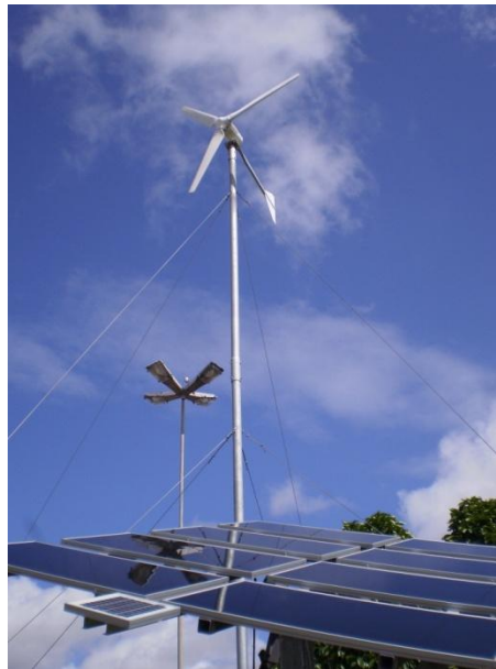
Figura 2.18: Sistema híbrido eólico-fotovoltaico na CT-GÁS ER
