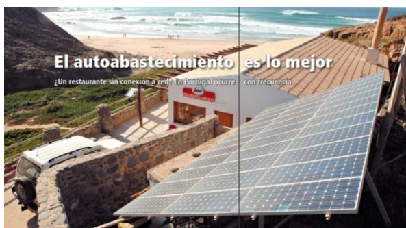
Figura 2.11: Sistema fotovoltaico-diesel na praia de Castelejo em Portugal
