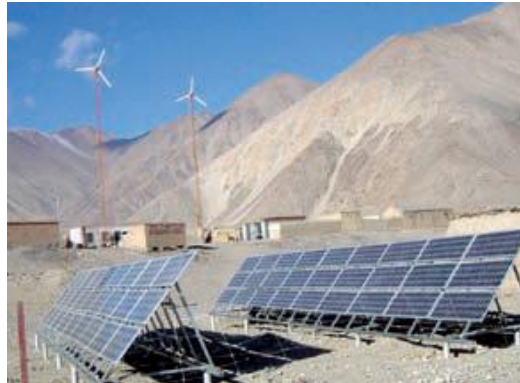
Figura 2.14: Sistema fotovoltaico-eólico-Diesel na China
