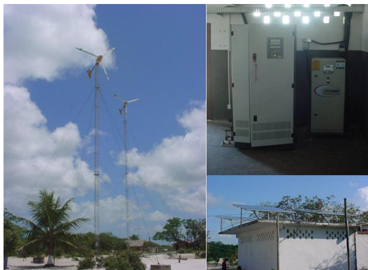
Figura 2.15: Sistema fotovoltaico-eólico-Diesel em Tamaruteau- Pará
