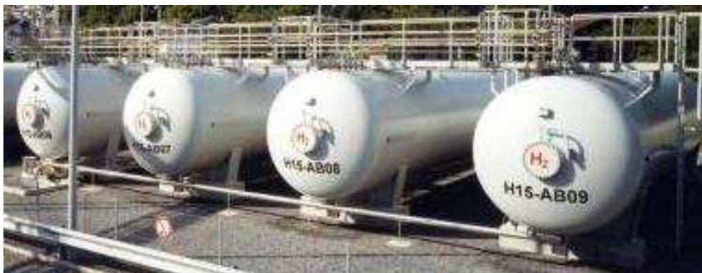
Figura 3.4 – Tanques de armazenamento de hidrogênio a 30 bar. Fonte: ELT, 2011.
