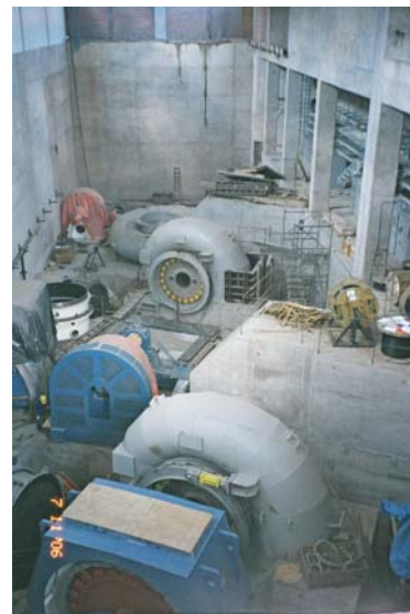
(5.7) Casa de força e os grupos turgo-geradores sendo instalados na PCH Mosquitão
