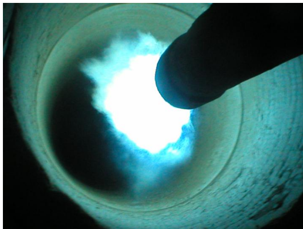
Fig. 2.27: Queimador C.Greco em processo de aquecimento de um forno rotativo
