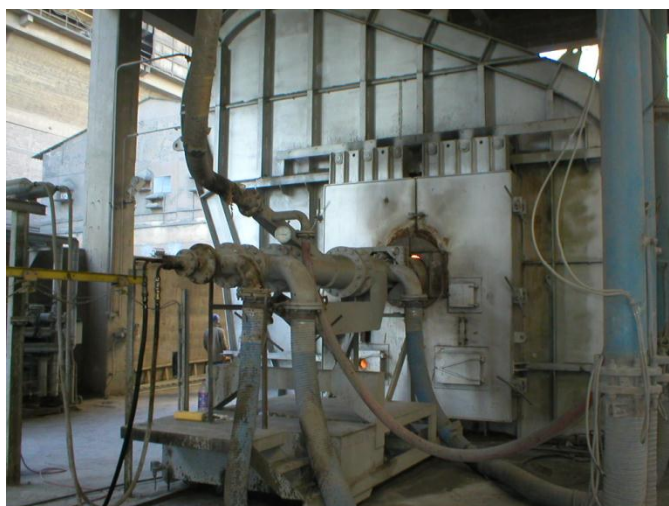
Fig. 2.28: Queimador C.Greco em operação
