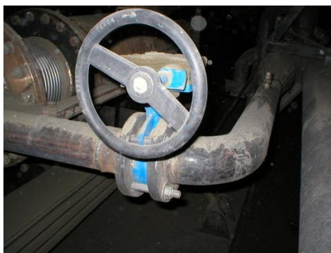
Fig. 12.6: Localização da válvula borboleta do canal tangencial do queimador CD2-NA
