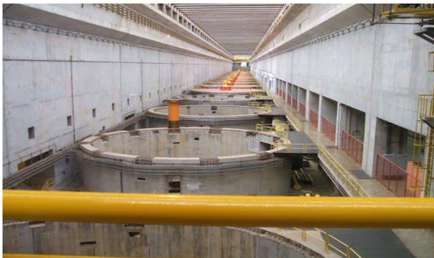
Fonte: Google Earth – Panoramio, acesso em 11/01/2014 Figura 2.10: Vista interna da casa de força da UHE Porto Primavera
