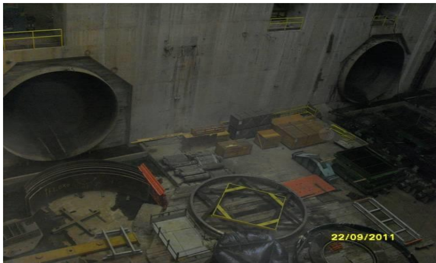
Fonte: Foto tirada pelo autor da dissertação (2011) Figura 2.15: Condutos de adução aos poços vazios da UHE Governador Bento Munhoz
