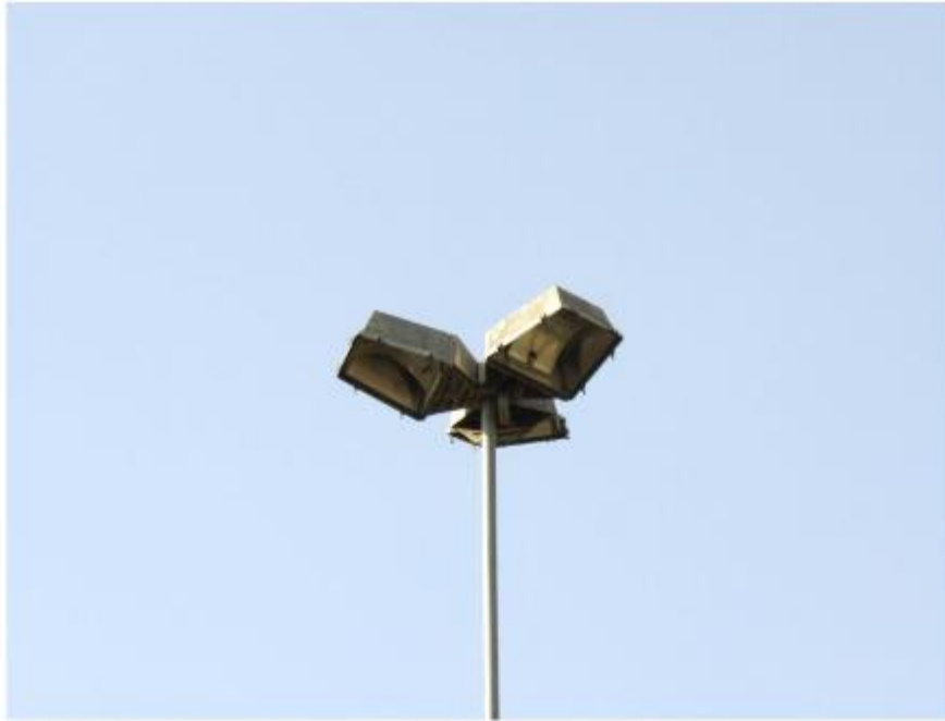
Figura 2.11 – Luminária de três pétalas com lâmpadas VSAP [14]
