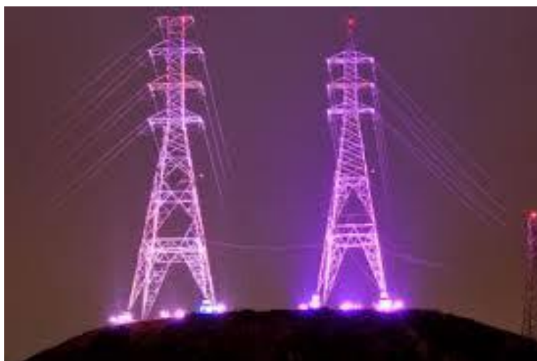
Figura 6 – Efeito Corona em torres de alta tensão. Fonte: (energyservice.comunidades.net).
