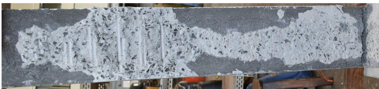
Figura 46 – vista inferior da placa de CUADRF após a falha
