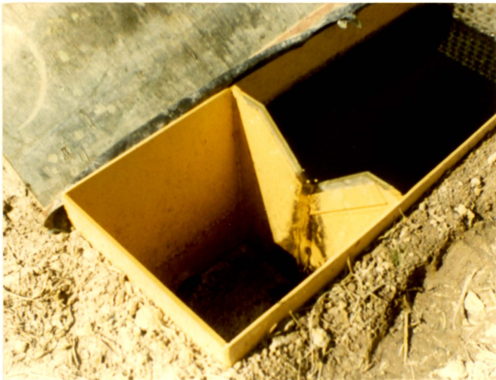
Figura 17. Detalhe da caixa de medição de vazão com o efluente tratado passando pelo vertedor.
