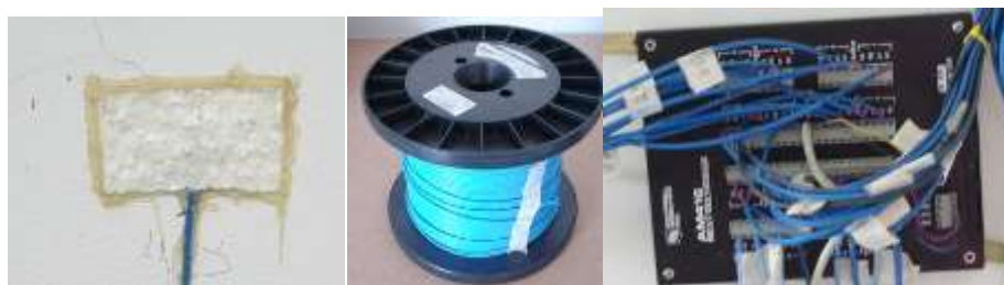
Figura 38 – Sensor de temperatura superficial externo (Termopar) e central de dados.
