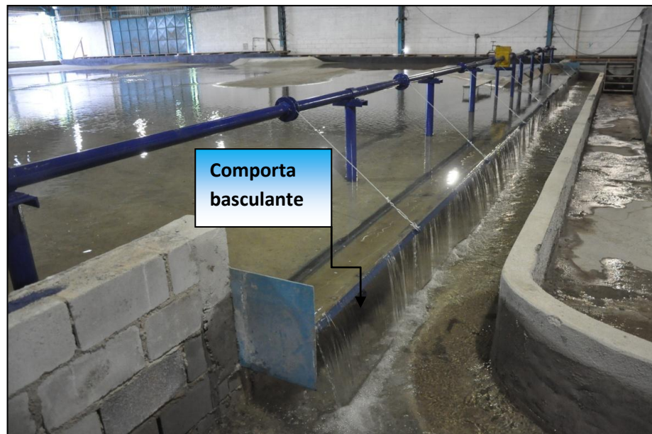
Foto 4.5. Comporta de jusante.
