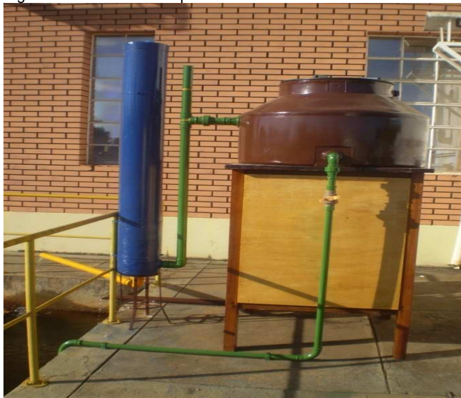
Figura 4.4 – Clorador de pastilhas de ATCI instalado na ETA Franca
