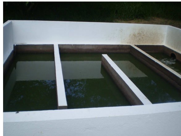
Figura 4.12 - Tanque de contato da ETE Itirapuã
