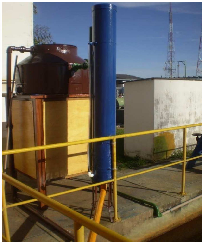
Figura 4.2 Clorador de pastilhas de ATCI instalado na ETA Franca
