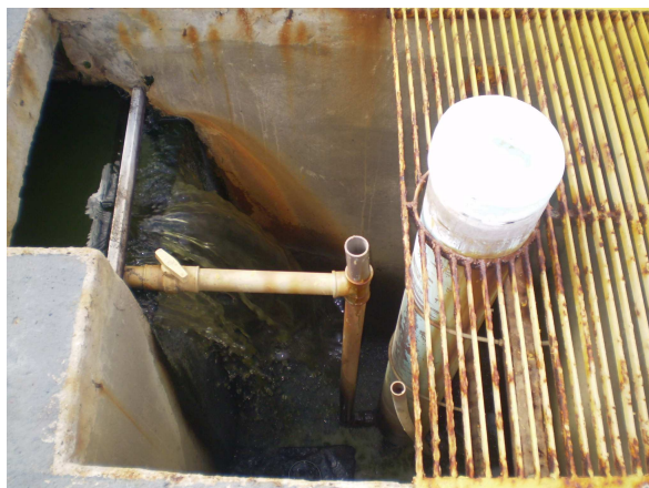
Figura 4. 14 – Detalhe do fluxo do esgoto no clorador
