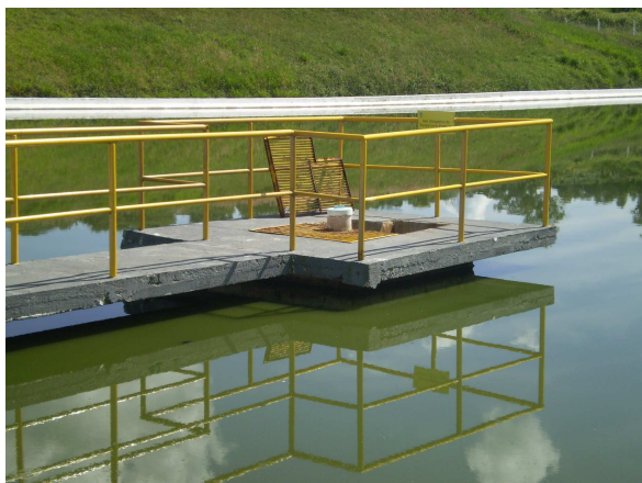
Figura 4.13 – Clorador instalado na ETE de Itirapuã
