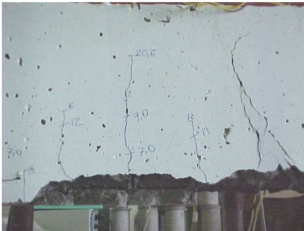
FIGURA A.11 – Detalhe do destacamento de concreto na região de emenda
