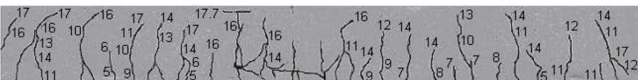
FIGURA 6.3 – Detalhe do panorama de fissuração da viga 3
