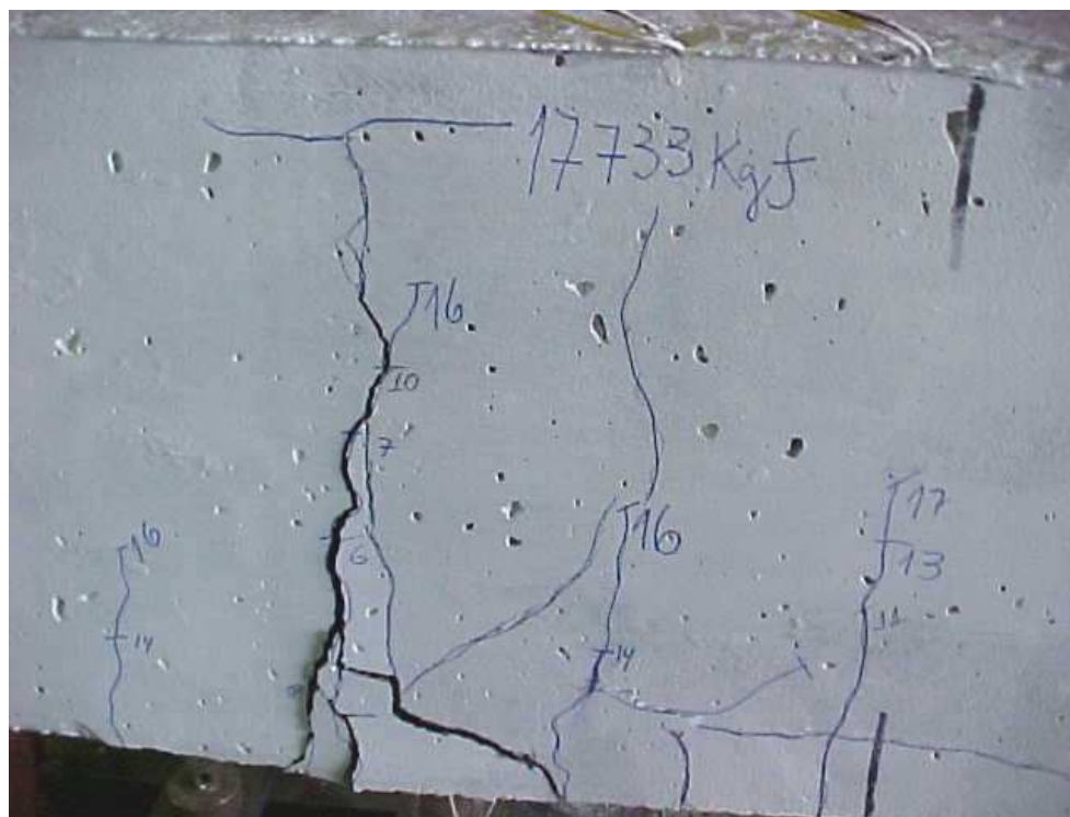
FIGURA A.9 – Vista lateral. Detalhe da fissura na região das emendas
