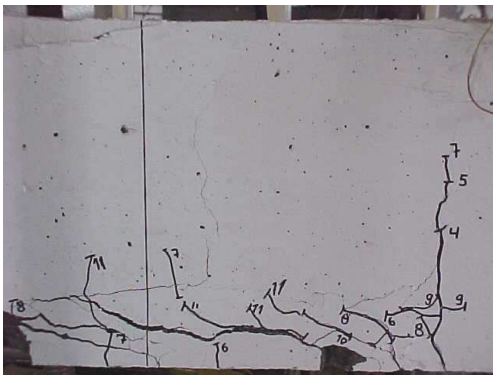
FIGURA A.13 – Detalhe da evolução das fissuras
