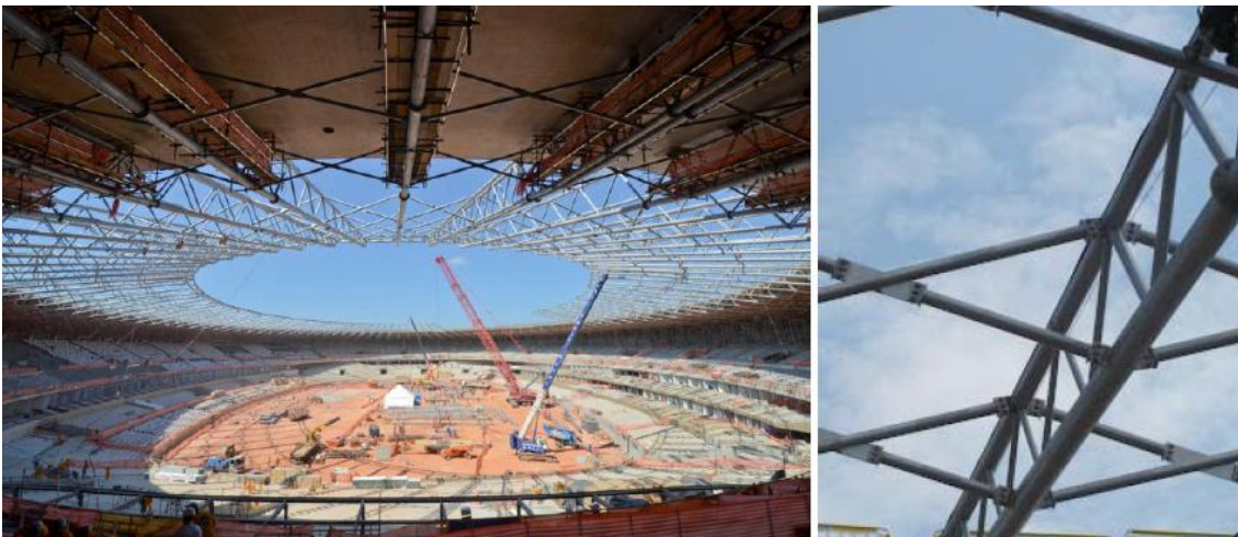
c) Reforma do Estádio Governador Magalhães Pinto, em Belo Horizonte por SEPÚLVEDA (2013)
