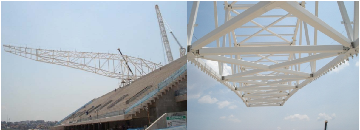
Figura 6. Primeiro conjuntos de treliças da montagem da cobertura do Estádio Itaquerão – São Paulo. Fonte: Arquivo pessoal.
