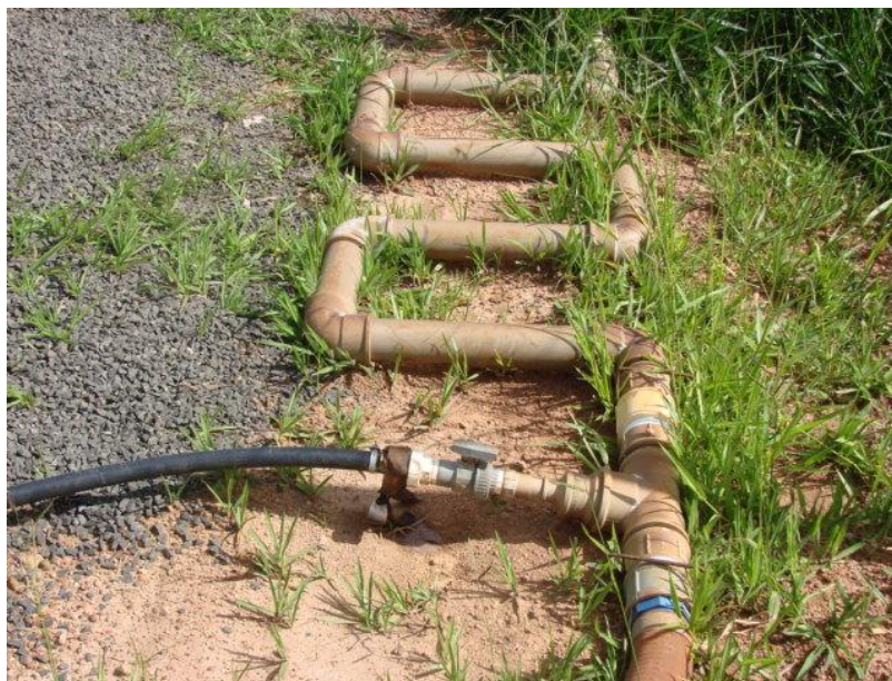
Figura 4.24 - Ponto de aplicação de polímero – ETE Pedregulho
