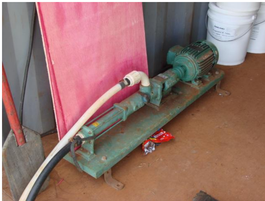
Figura 4.27 - Bomba utilizada para o polímero – ETE Pedregulho
