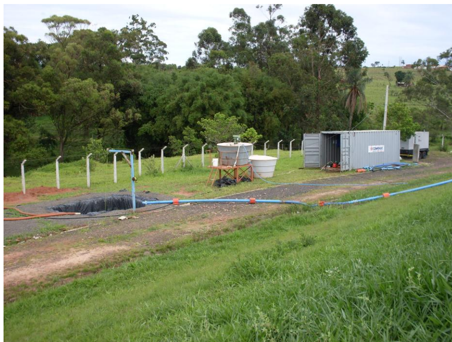
Figura 4.16 - Gerador, container, caixas de adição de polímero e caixa de recebimento de lodo da draga para posterior envio para o bag (11/12/2008)
