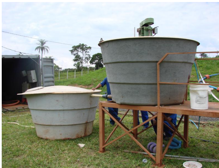
Figura 4.23 - Caixas de mistura de polímero – ETE Pedregulho
