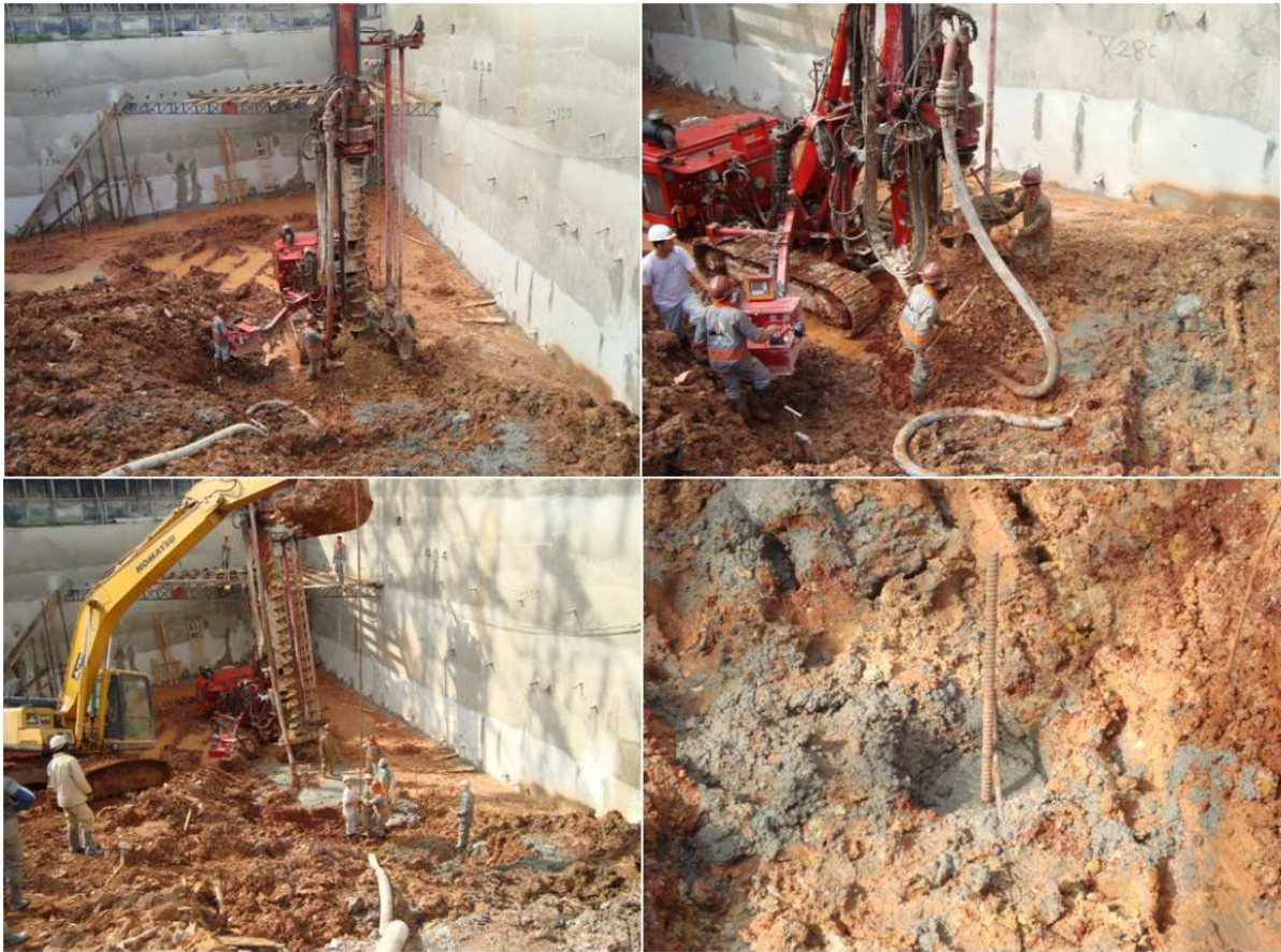
Figura 5.11: Execução de estacas hélice segmentada para reação de prova de carga sobre placa.
