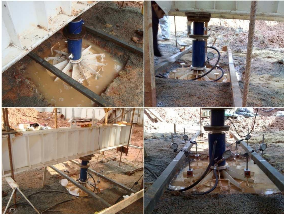
Figura 5.20: Montagem de macaco e célula de carga para prova de carga sobre placa.
