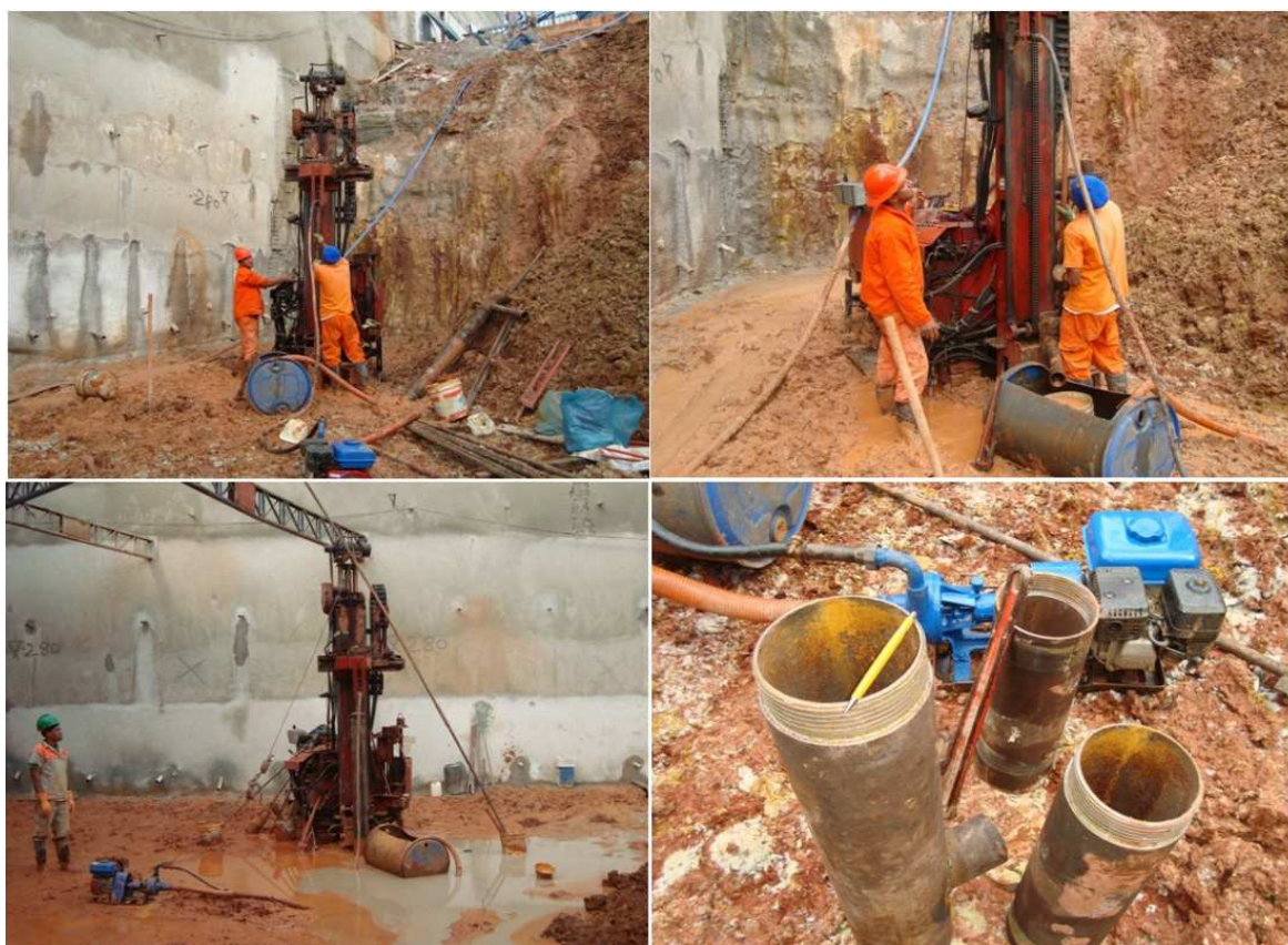
Figura 5.10: Tentativa de execução de micro-estacas para reação de prova de carga sobre placa.
