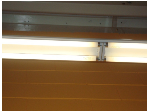
Figura 29 – Luminárias utilizadas no salão principal de vendas do hipermercado B.
