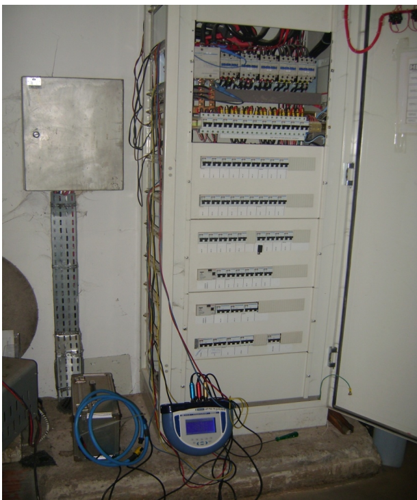
Figura 35 – Quadro que alimenta os circuitos de iluminação do hipermercado A, onde foram instalados os analisadores de energia.
