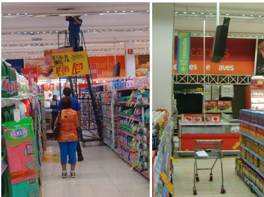
Figura 63 – A existência de obstáculos que bloqueiam a luz emitida pelas luminárias.
