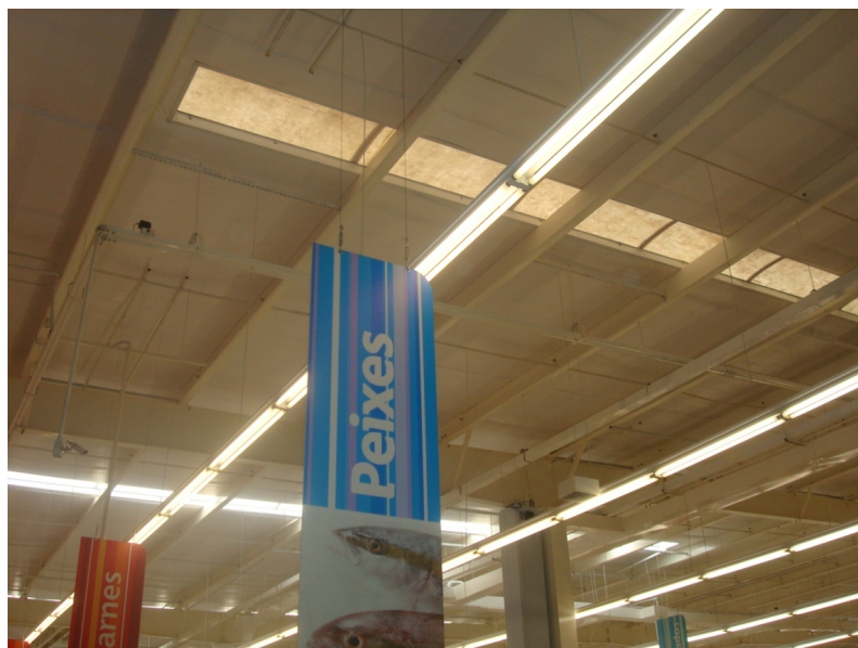
Figura 68 – Aberturas zenitais com bloqueio.
