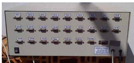
Figura 5-20: Unidade de tratamento de sinais - Sistema de aquisição de dados.
