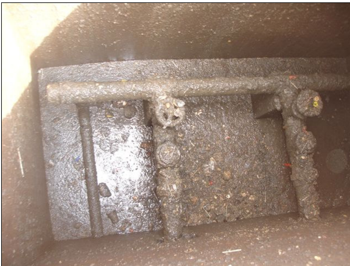
Figura 7.15 Poço de sucção da Elevatória Joana D'arc B02 19.
