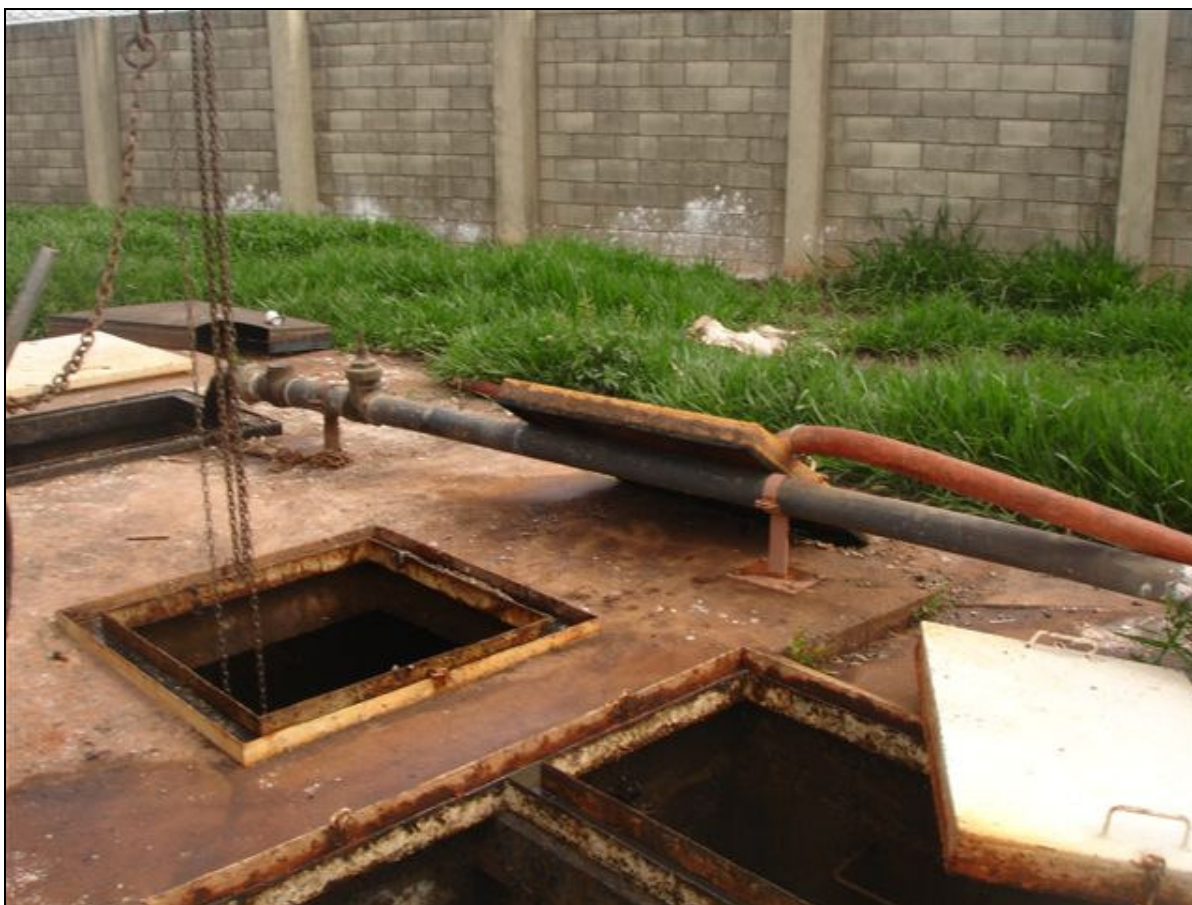
Figura 7.14 Poço de sucção da Elevatória Joana D'arc B02 19.
