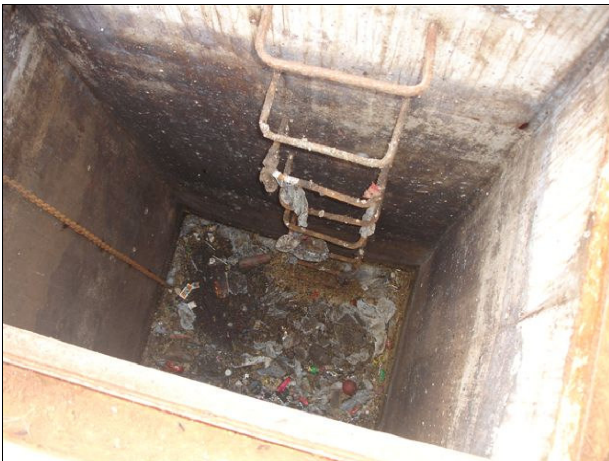
Figura 7.16 Poço de sucção da Elevatória Joana D'arc B02 19.
