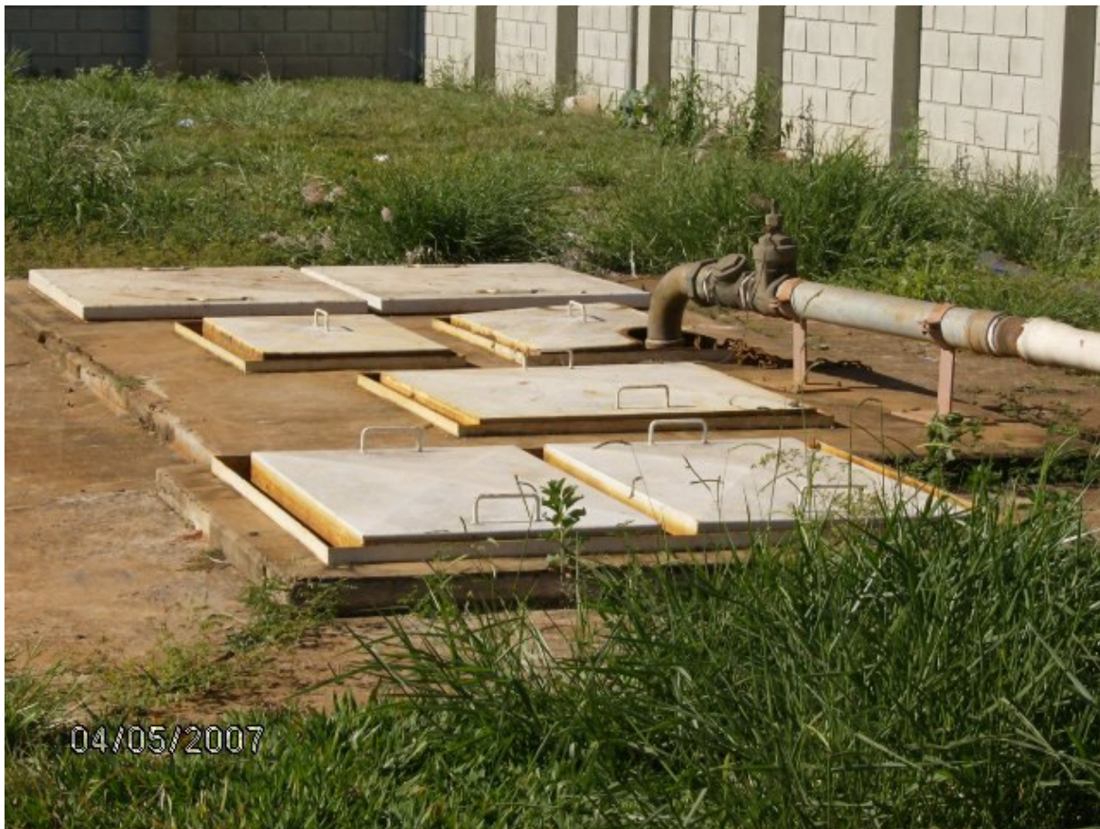
Figura 7.8 Poço de sucção da Elevatória Joana D'arc B01 18
