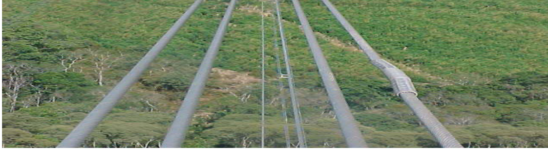
Fig. 1.1 Não conformidade de emenda pré-moldada em L.T. de alta tensão aérea.
