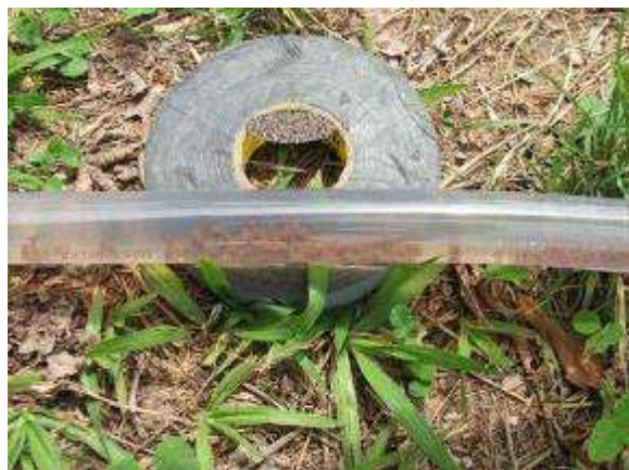
Figura 71: Formação de lodo na tubulação transparente de adução das ETAs
