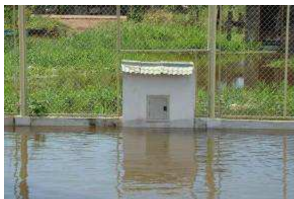
Figura 94: Pico da cheia do Rio Solimões – Caixa de entrada de energia para a ETA Km 13 em 28/07/09
