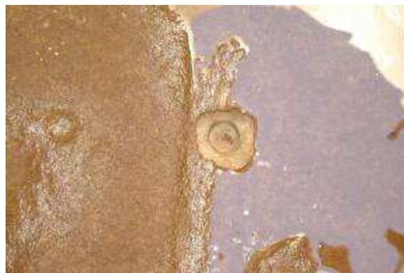
Figura 85: Furo da camada biológica na drenagem do FL da ETA Rio Negro
