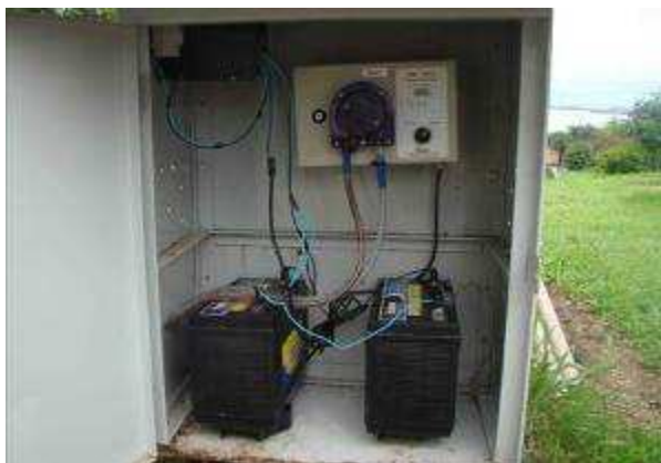
Figura 74: Painel de guarda da bomba peristáltica, carregador e conjunto de baterias
