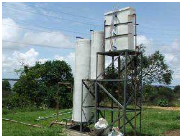
Figura 54: ETA Rio Negro montada
