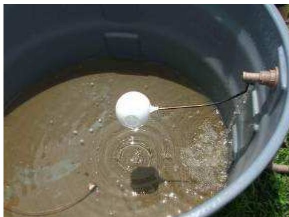
Figura 73: Reservatório para regularização de vazão das ETAs
