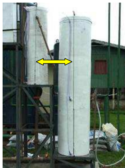
Figura 63: Tirantes de fixação dos equipamentos em fibra de vidro
