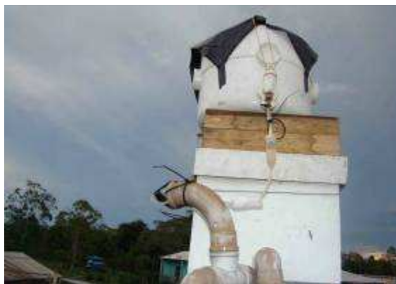
Figura 137: Segunda montagem do sistema de dosagem – ETA Rio Solimões
