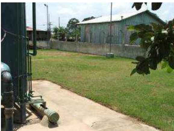
Figura 55: Local da Instalação da ETA Rio Solimões, em Careiro da Várzea-AM
