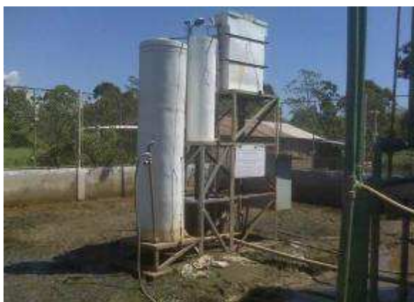
Figura 98: Final do alagamento na área da ETA Rio Solimões em 01/08/09
