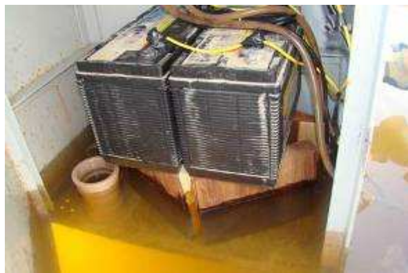
Figura 97: Pico da cheia do Rio Solimões – Interior do painel elétrico da ETA Rio Solimões em 28/07/09
