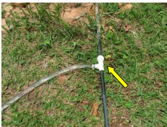
Figura 80: Derivação na tubulação para captação de água na ETA Rio Negro
