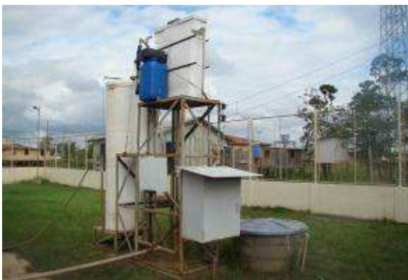
Figura 148. Sistema de dosagem de coagulante final – ETA Rio Solimões
