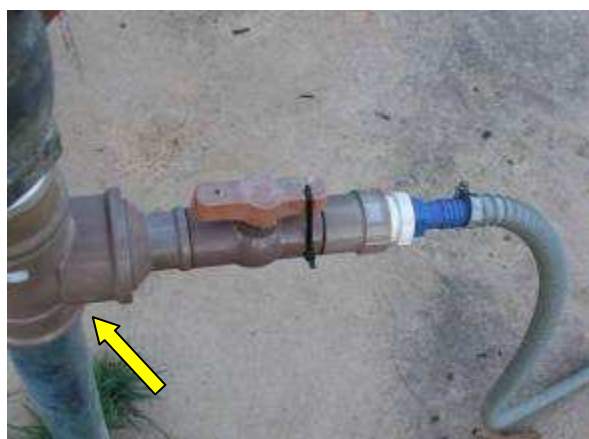
Figura 81: Derivação na tubulação para captação de água na ETA Rio Solimões
