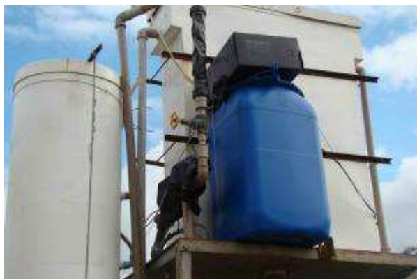
Figura 149. Configuração final do sistema de dosagem– ETA Rio Solimões
