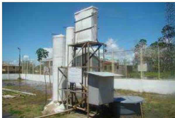
Figura 91: Início do alagamento da ETA Rio Solimões
