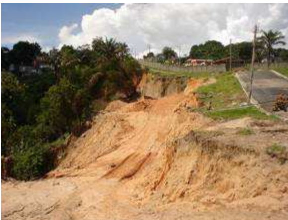
Figura 60: Deslizamento de encosta na área interna da ETA Mauazinho
