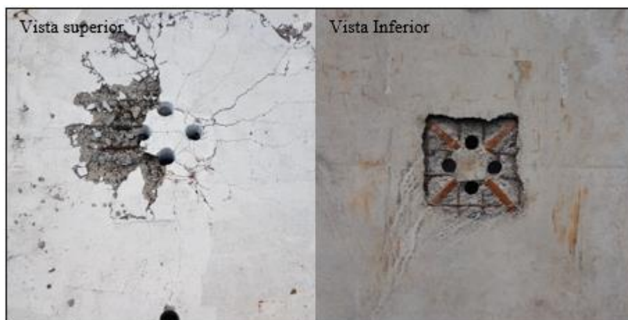
Figura 4.59 – Vista superior e inferior da laje L4-75-4s pós ruptura.
