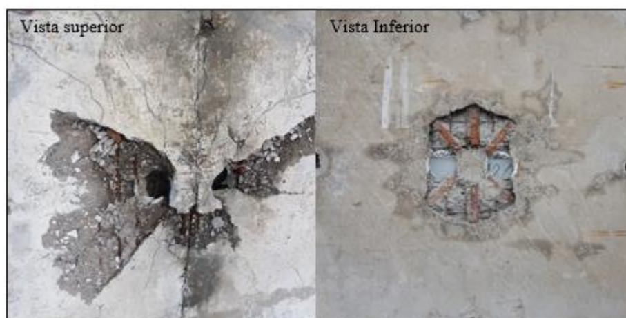
Figura 4.56 – Vista superior e inferior da laje L2-150-6s pós ruptura.
