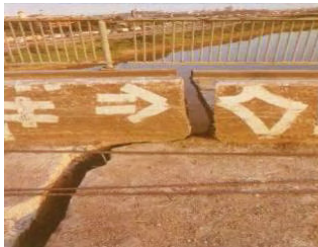
Figura 1.1 – Ponte dos Remédios, em São Paulo: problema típico causado pela falta de manutenção (COZZA, 1997).
