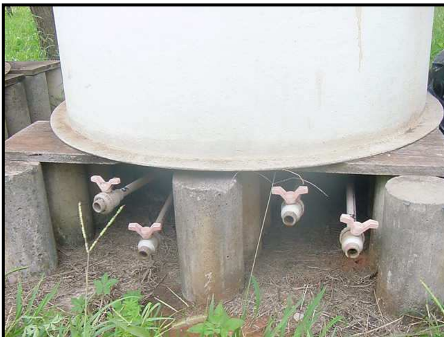
Figura 7 – Registro dos coletores de drenagem livre.
