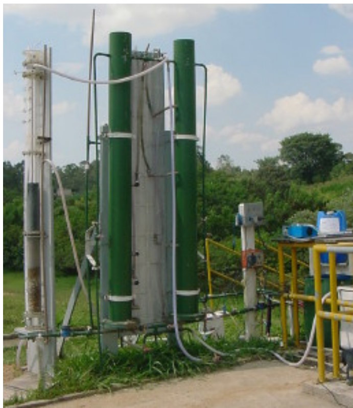
Figura 4.3 – Instalação piloto de tratamento terciário na ETE Samambaia, Campinas-SP
